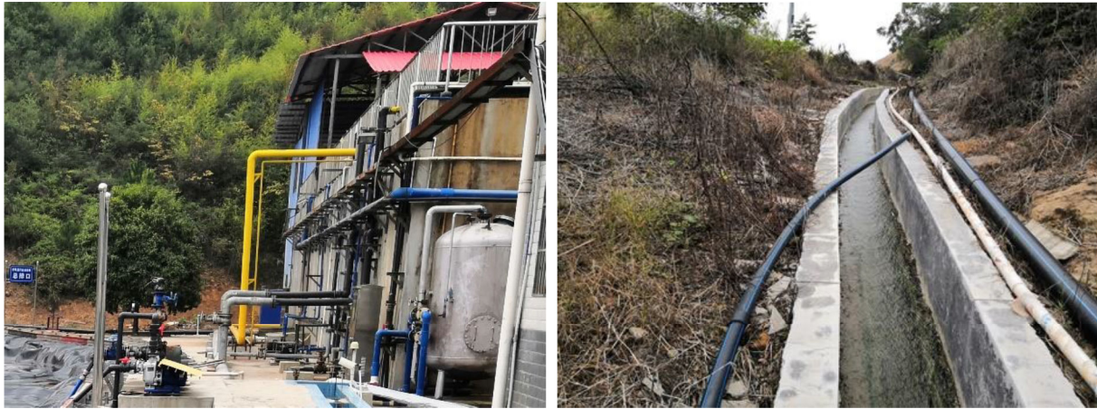
渗滤液输送管道
