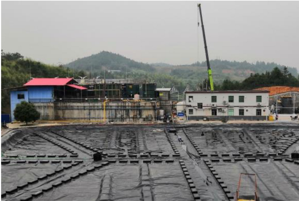
垃圾渗滤液处理系统
